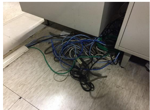
床面に露出した配線
