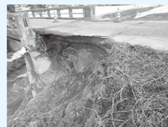
下河原橋の欠損部分
