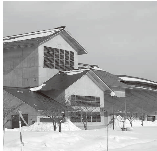
非常用電源になるソーラーパネル = フレンドリープラザ
