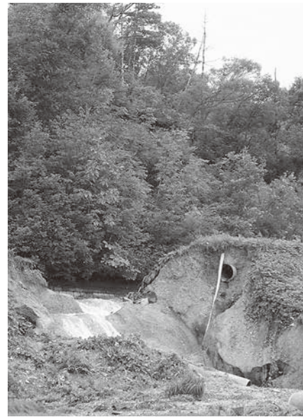
大雨被害を受けた長堀堰
