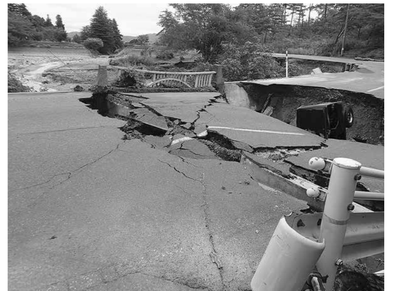
ダリヤ園との動脈が破損
