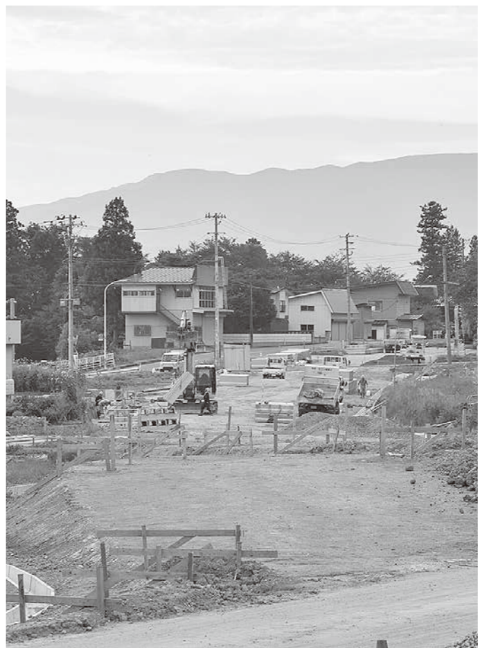
米沢市側からも工事が進み全容が見えてきた = 米沢市側からのぞむ
