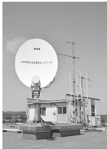
県防災通信アンテナと町の送信アンテナ
