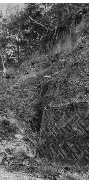
冠水による水路側面土砂流出 = 内山沢
