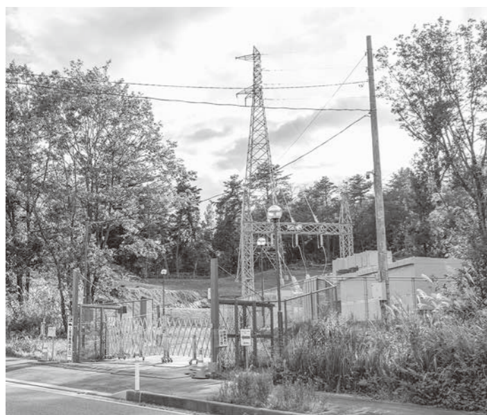
ソーラー発電変電施設(東陽寺前)
