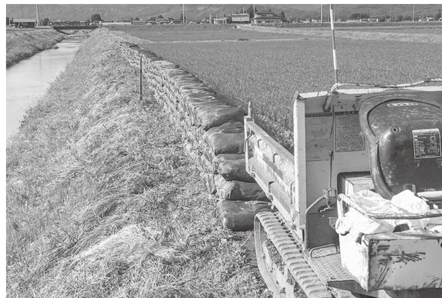
堤防に土のう(応急措置)で嵩上げ = 万福寺川
