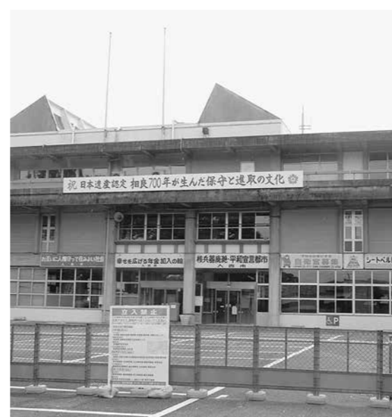
被災した人吉市役所。内部の柱、はりにはびびだらけ。
