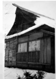
▲修復工事前の庫裏の北側。屋根裏に、はしごがないと登れない隠し部屋があった。
